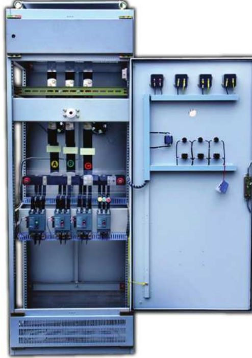
Görsel 6.23: Ana dağıtım panosu
