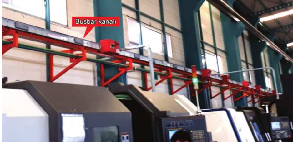
Görsel 3.4: Busbar kanalları
