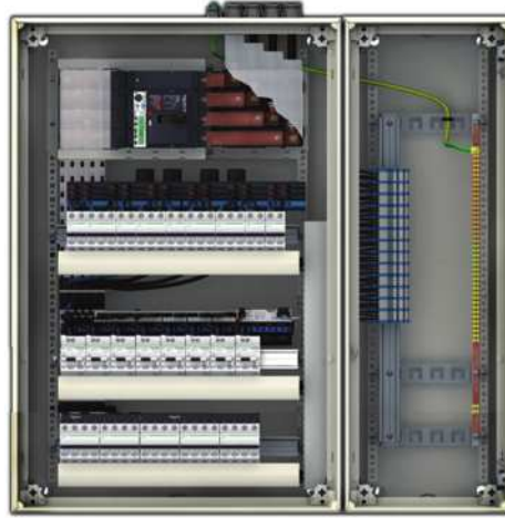
Görsel 6.24: Tali dağıtım panosu
